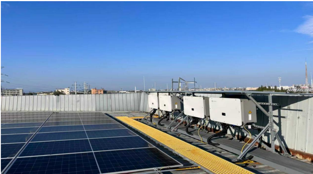
图 8.1 搅拌站顶面分布式光伏
