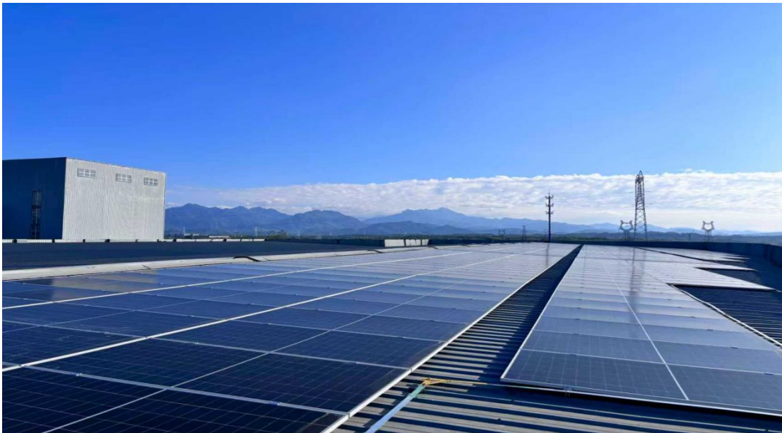
图 8.2 原料堆场顶面分布式光伏板
